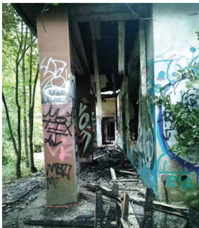
Budynek biurowo-sztabowy, który został spalony w ostatnim pożarze miał zostać przekształcony w miejsce dla społeczności lokalnej, z funkcją gastronomiczną i ogólnodostępną salą dla organizacji spotkań mieszkańców i różnych wydarzeń. Niestety, ogień strawił dużą część budynku. Czy uda się go w przyszłości wykorzystać tego nie wiadomo.
